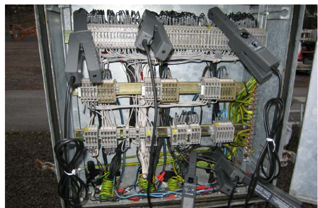
Figura 3 Quadro elettrico con pinze amperometriche
